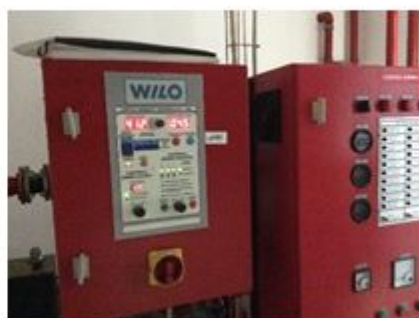
Central de Incêndios
